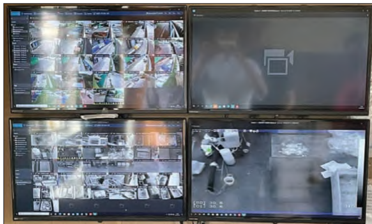
31 telecamere termografiche si allarmano in caso di aumento repentino della temperatura
